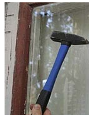
Фото 9. Установить на место стекло, закрепить штапик (при необходимости - заменить его)
