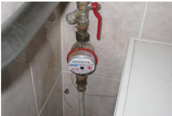
на фото: счетчик воды, установленный в квартире Ольги Сеновой
