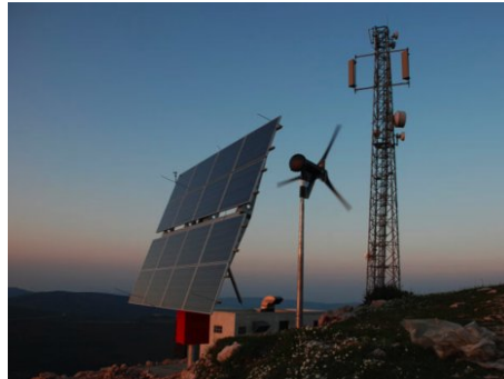
на фото: станция оператора связи Avea
